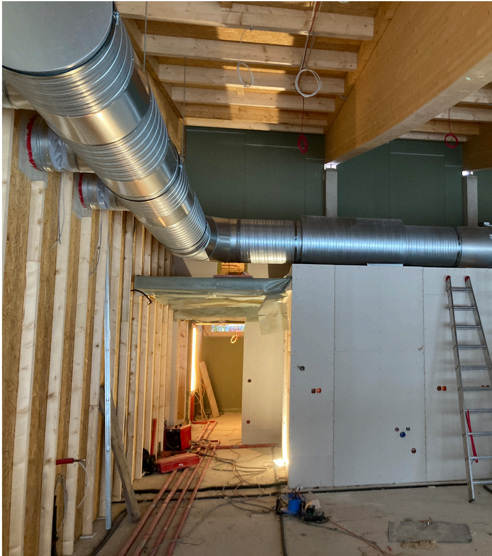
Raum Narrenzunft - Lüftungsleitungen Galerie Halle
