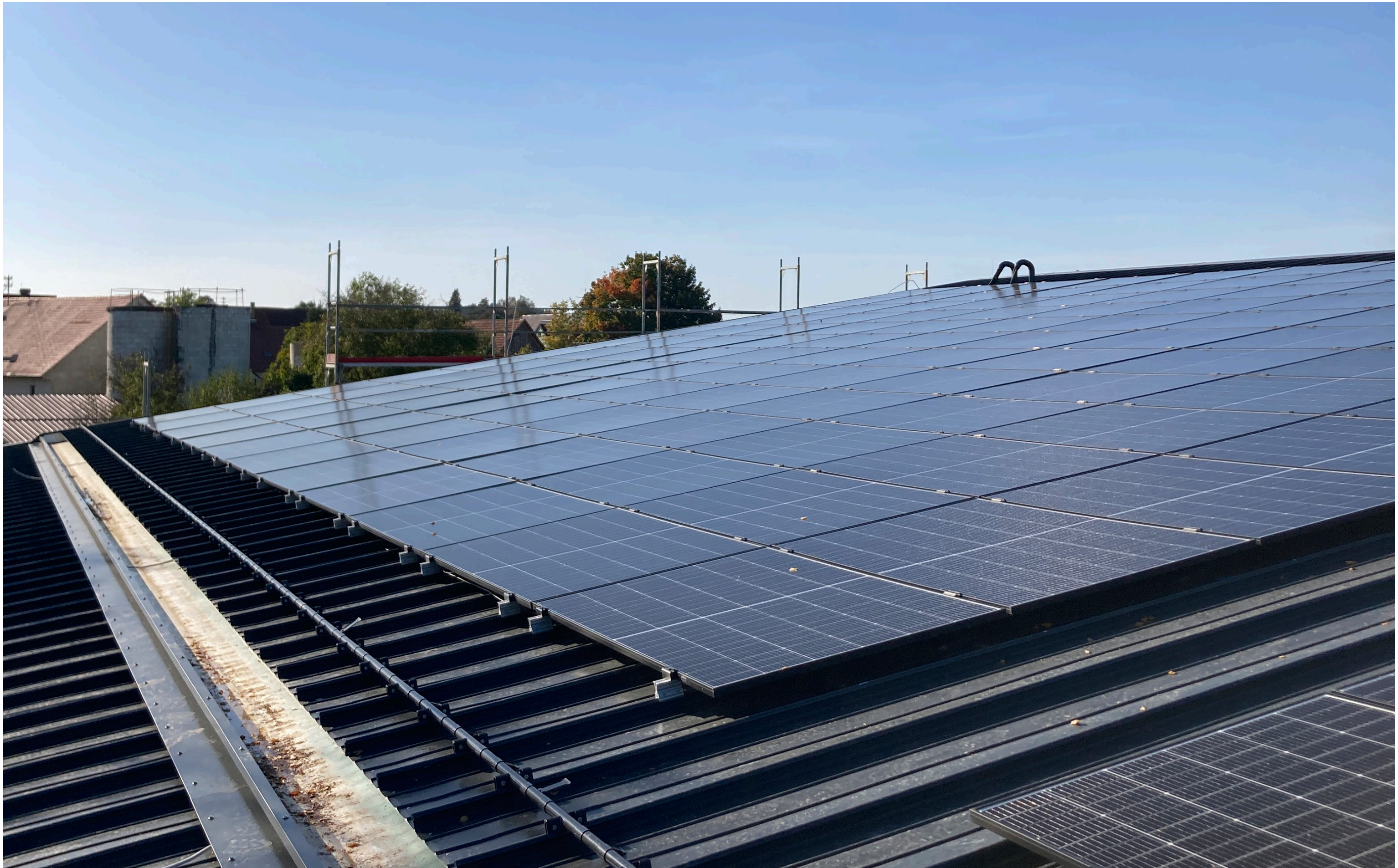
Blechdacheindeckung und PV-Module Hallendach
